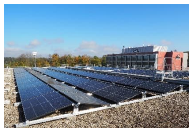
Solaranlage auf dem Dach
