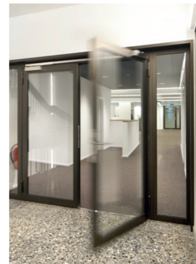
Brandschutztüre mit Schliess-Automatik
