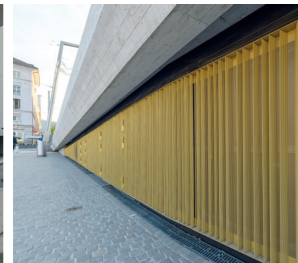
Verdeckt liegende Türen mit Lochblechtrapez-Verkleidung
